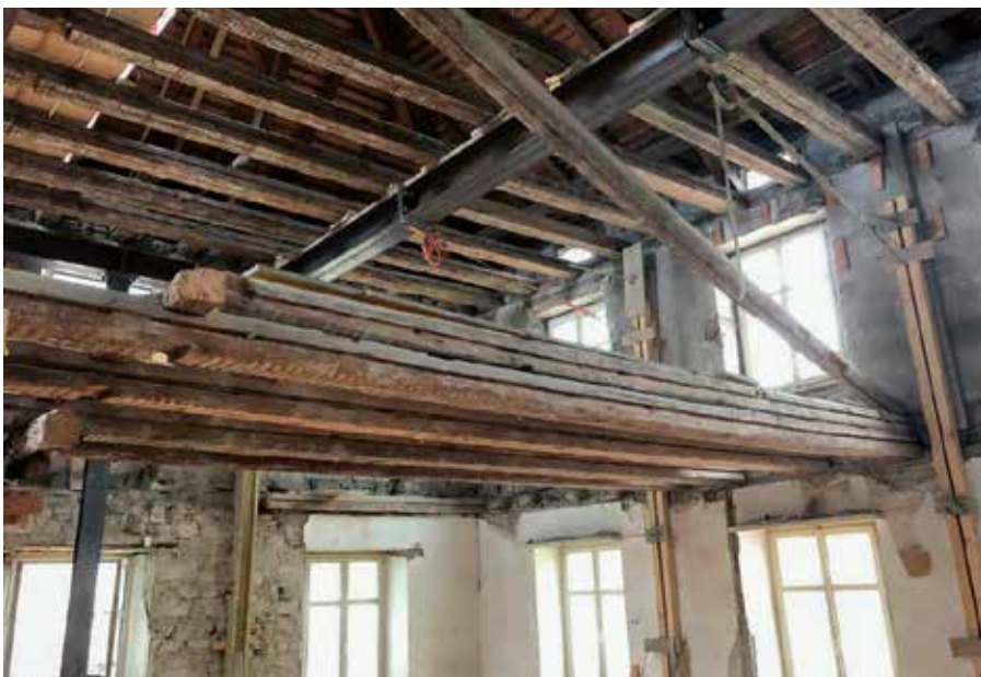
Der 1867 neu erbaute Nordflügel während des Umbaus, rechts Reste einer Bemalung auf den Innenwänden. Fotos: Schwabegger & Zoller Architekten, Altstätten.
